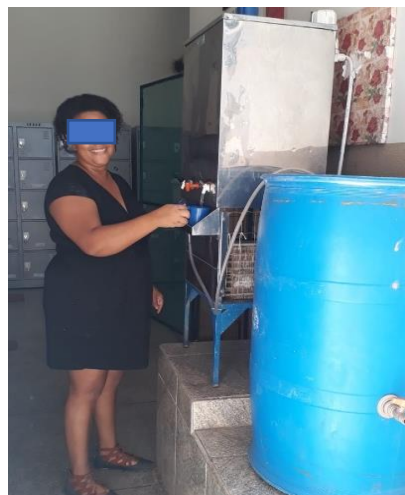
Figura 2 - Imagem do sistema de captação de água do bebedouro
