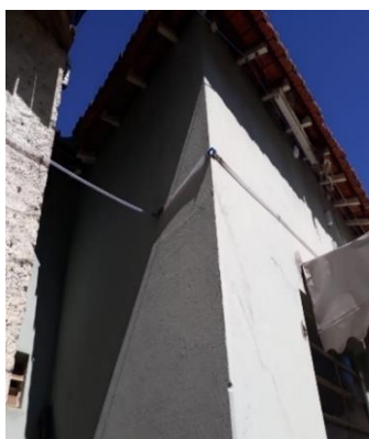
Figura 5 - Imagem do sistema no segundo pavilhão
